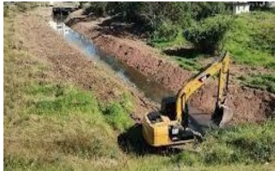
Figura 5: Canal de drenagem
