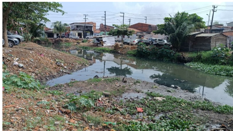
Figura 15: Assoreamento ao longo do canal
