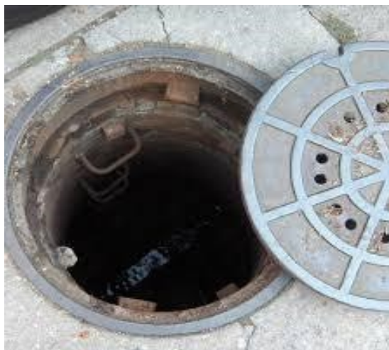
Figura 4: Poço de visita
