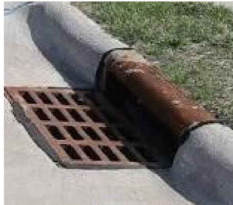
Figura 1: Boca de lobo
