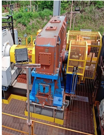
Figura 8 - Redutor de velocidade.
