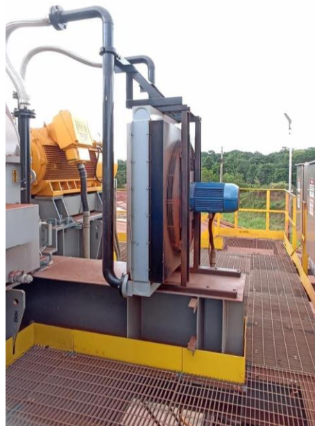
Figura 11 - Ventilador (trocador de calor).
