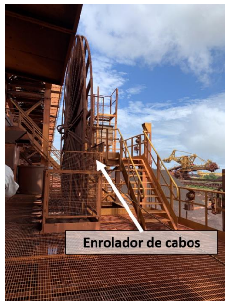
Figura 77 - Condição do enrolador de cabo.
