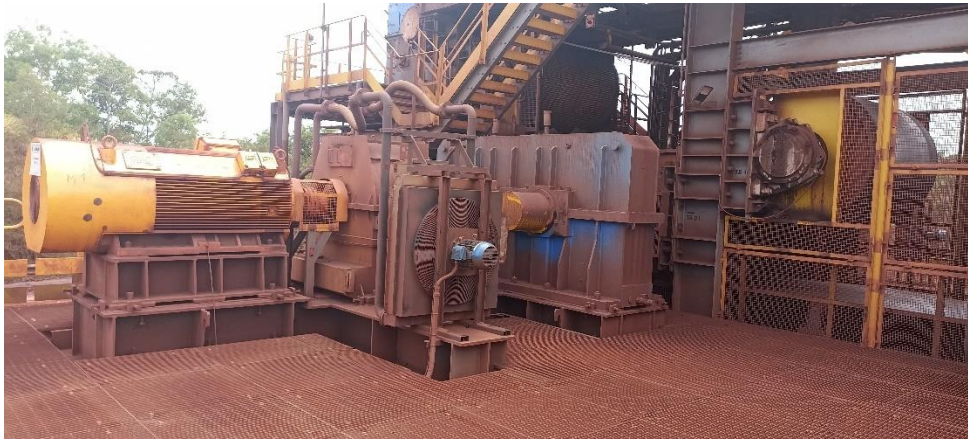
Figura 62 - Novo conjunto de acionamento.
