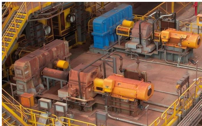
Figura 6 - Conjunto de acionamento.
