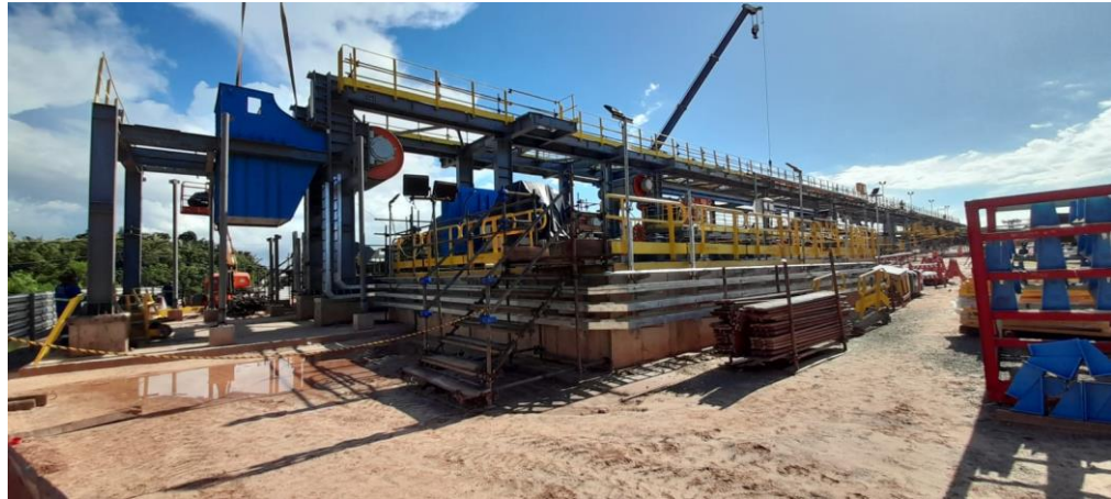
Figura 58 - Estruturas da cabeceira do transportador.
