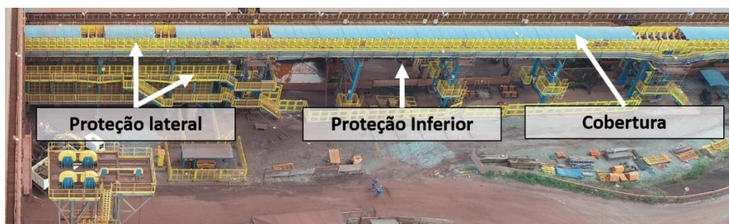
Figura 68 - Proteções e cobertura do transportador.
