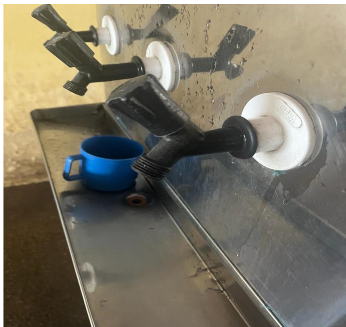
Figura 1: Escola 1- torneiras bebedouro 1
