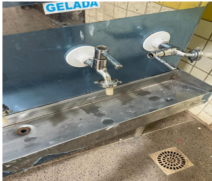
Figura 9: Escola 2- torneiras bebedouro
