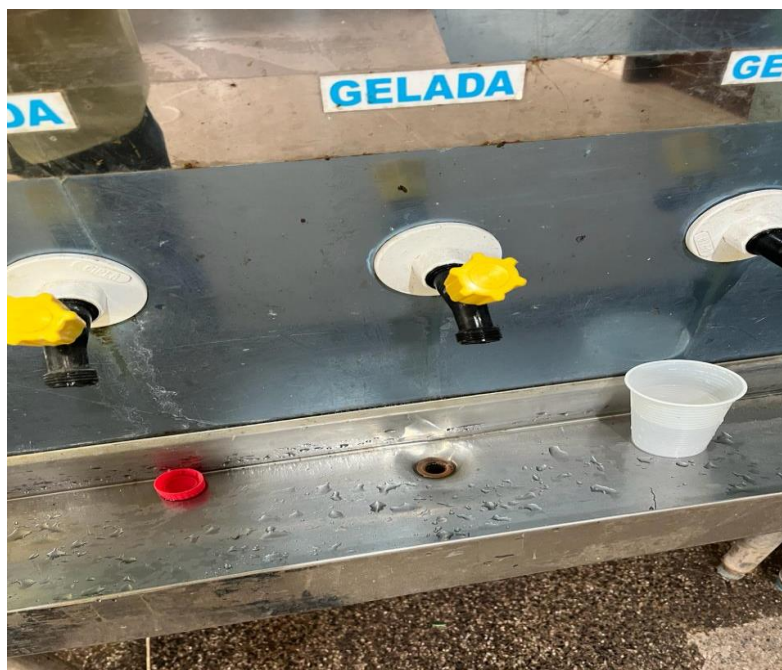
Figura 8: Escola 2 - torneiras bebedouro 1
