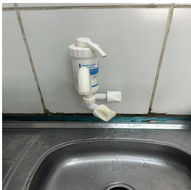
Figura 14: Escola 3 - torneira da cozinha
