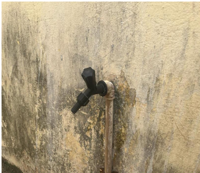
Figura 3: Escola 1 - torneira próxima ao poço
