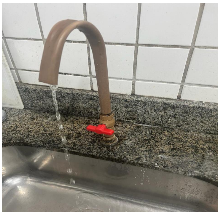
Figura 2: Escola 1- torneira da cozinha
