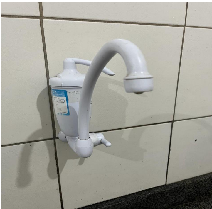
Figura 7: Escola 2 - torneira da cozinha
