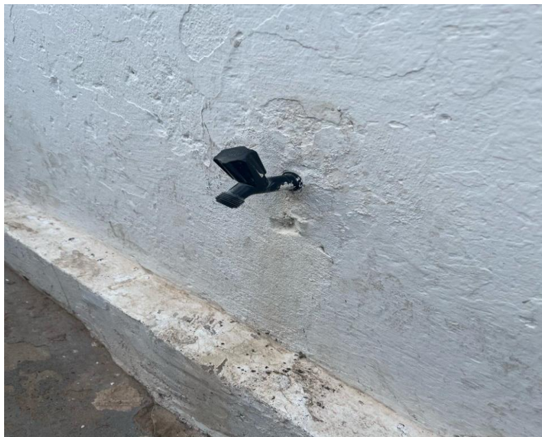
Figura 16: Escola 3- torneira próximo à caixa d'água
