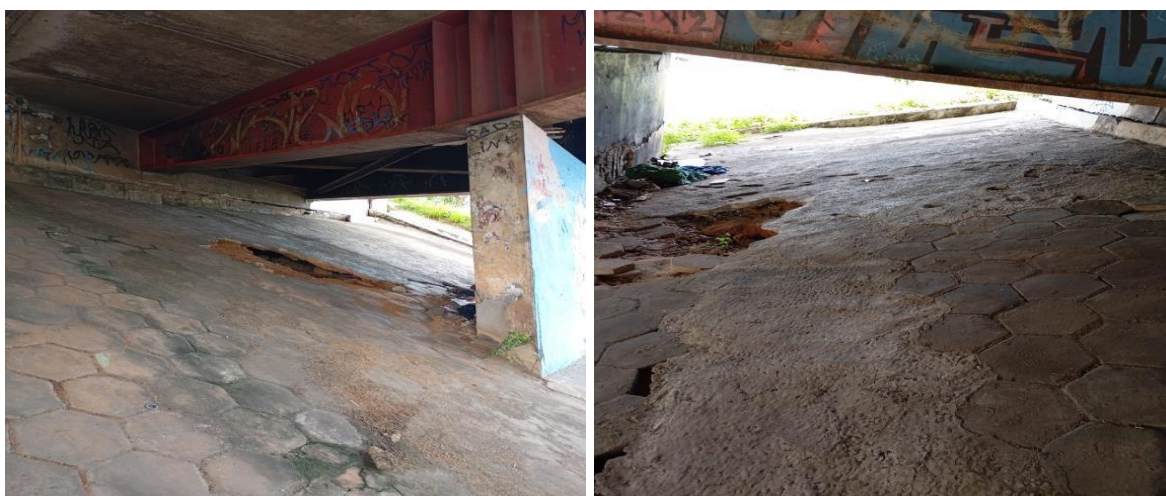
Figuras 13a e 13b: Solo do encontro mal compactado apresentando desprendimento dos paralelepípedos hexagonais.
