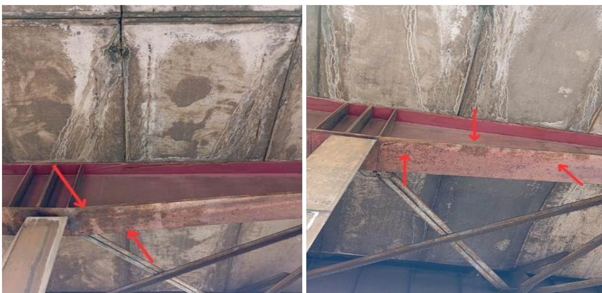
Figuras 11a e 11b: Processo de corrosão nas vigas longarinas do viaduto.
