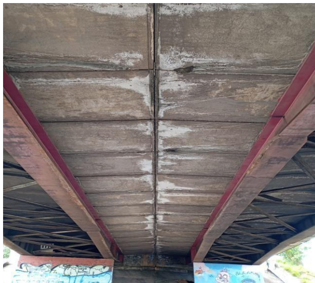
Figura 12: Ocorrência de eflorescência na laje do viaduto.
