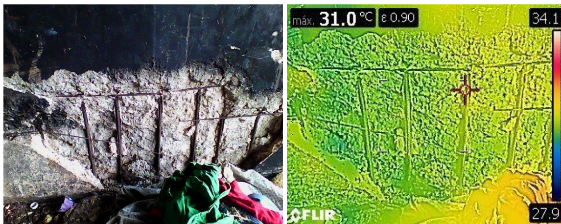
Figuras 17a e 17b: Análise termográfica em área de pilar com armadura exposta em processo de oxidação.
