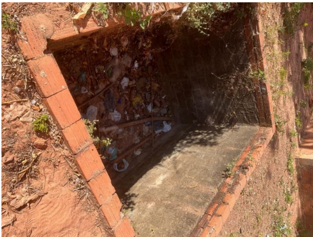
Figura 4 - Reservatório Inacabado com Acúmulo Resíduos
