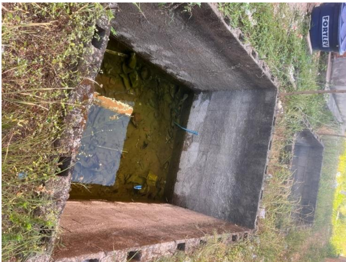
Figura 3 - Estrutura de armazenamento abandonada
