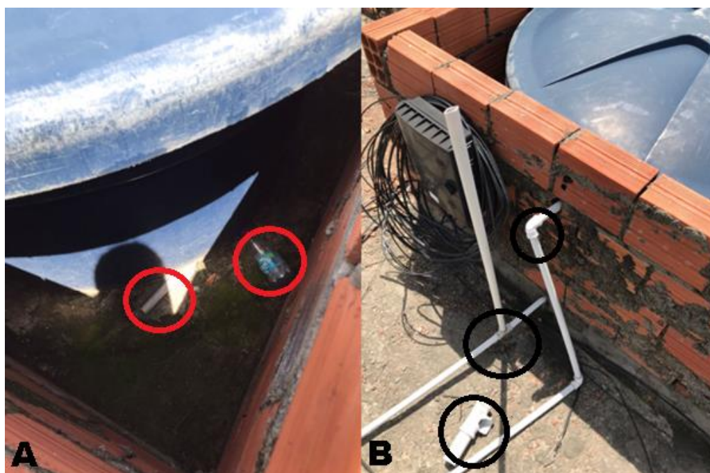
Figura 5 - Reservatório improvisado e encanamentos deteriorados
